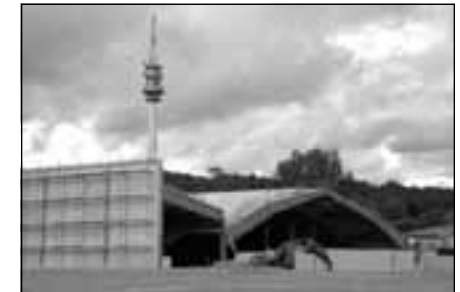
Baustelle TSG Sportforum: Ganz rechts ist die kleine Sporthalle (Aktionsraum) des Kindergartens zu erkennen, in der Mitte die Tennishalle und links davon die Badmintonhalle
