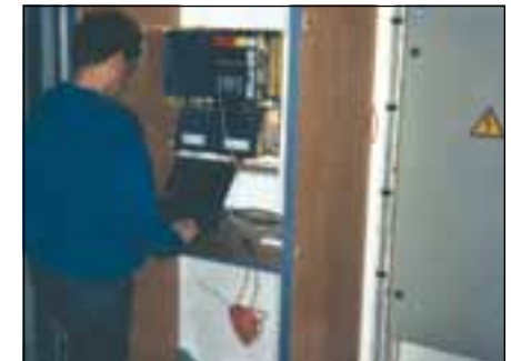
Überall kommen Kabelenden aus den Wänden
